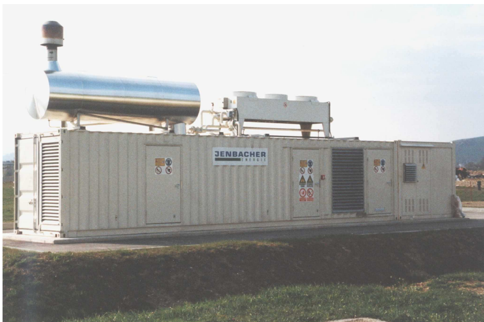
Slika 5: Mala plinska elektrarna za proizvodnjo električne energije (Vir: Snaga d.o.o.)
