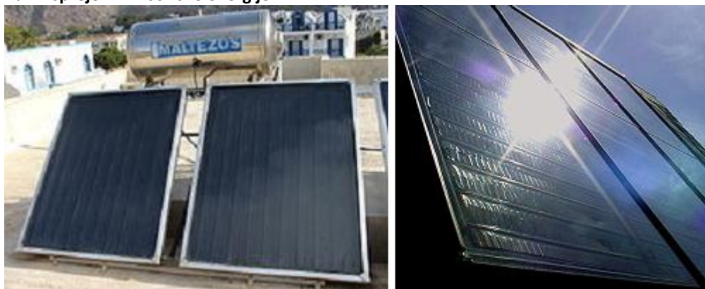
Ravni toplotni sistem za ogrevanje vode, nameščen na ravni strehi.
