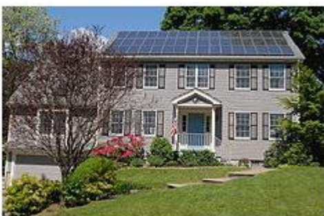
Fotovoltaični sprejemniki sončne energije na strehi hiše.
