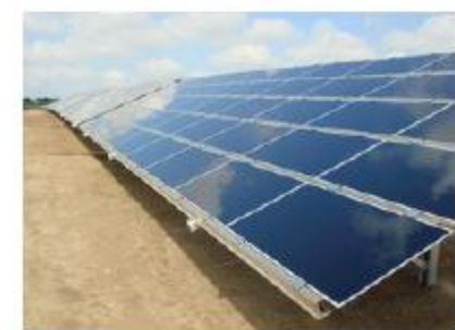
Park sončne energije s tankoslojnimi moduli, Worrstadt, Nemčija
