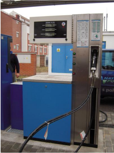
Slika 1: Primer črpalne postaje za zemeljski plin na Češkem
